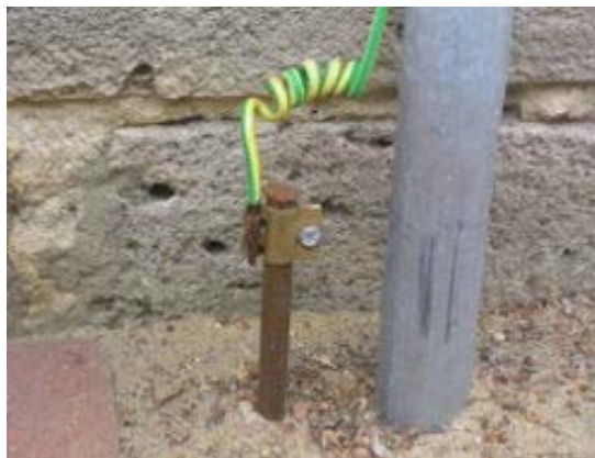
شکل ۷- یک نمونه اتصال الکتریکی به زمین در کنار مجرای عبور آب
