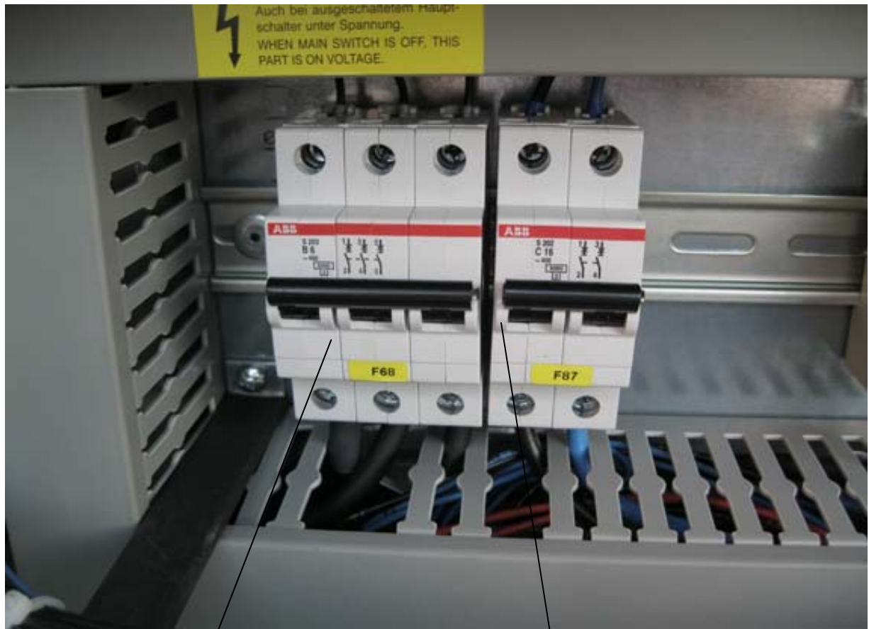
فیوز اصلی تابلو برق
